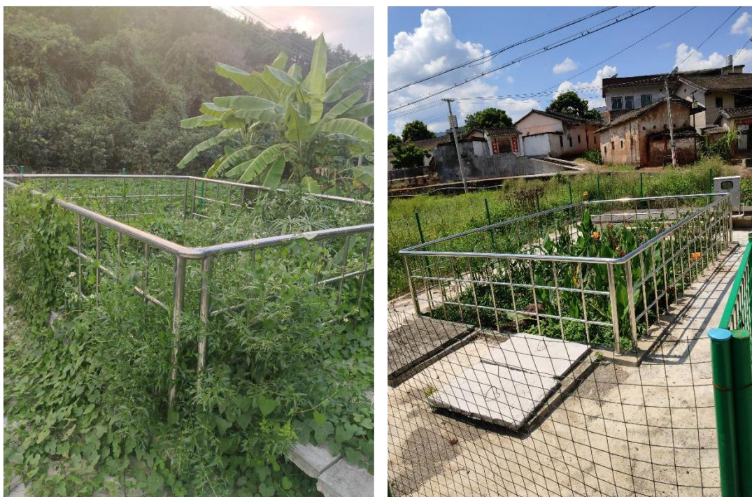
农村生活污水处理设施
