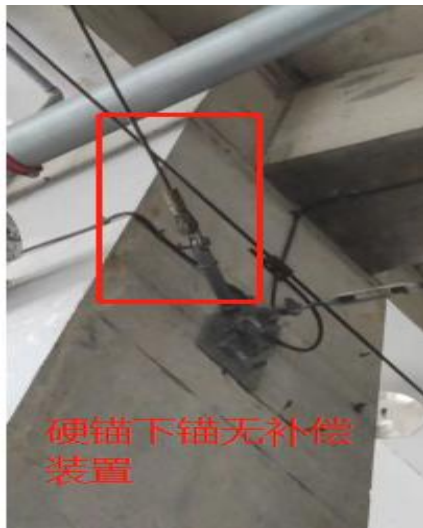
图3 小曲线锚段硬锚侧
