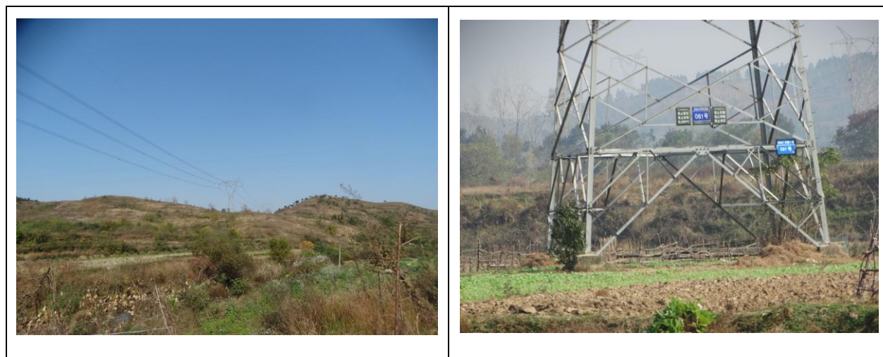
图 9-9 500kV 孝潏I回通过孝昌县城饮用水水源保护区实景照片
