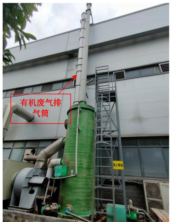
有机废气 15m 排气筒
