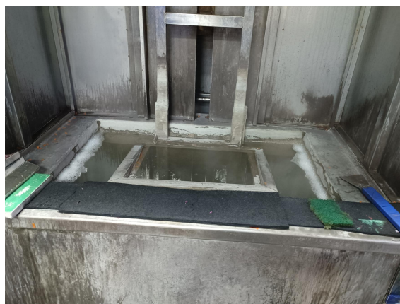
去树脂条工序清洗槽
